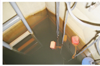
原有問題裝置 Existing problem installation
